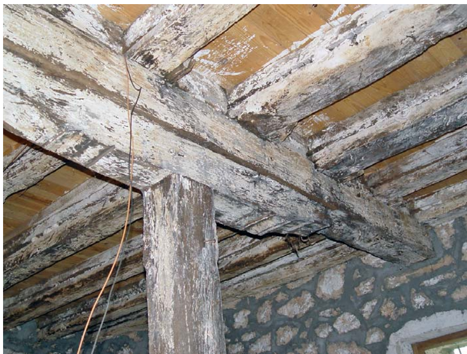
Slika 11: Stari drveni strop iznad podruma
