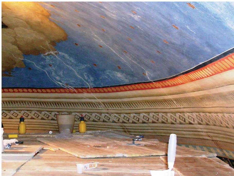
Slika 12: Napukline na kamenom svodu iznad oltara
