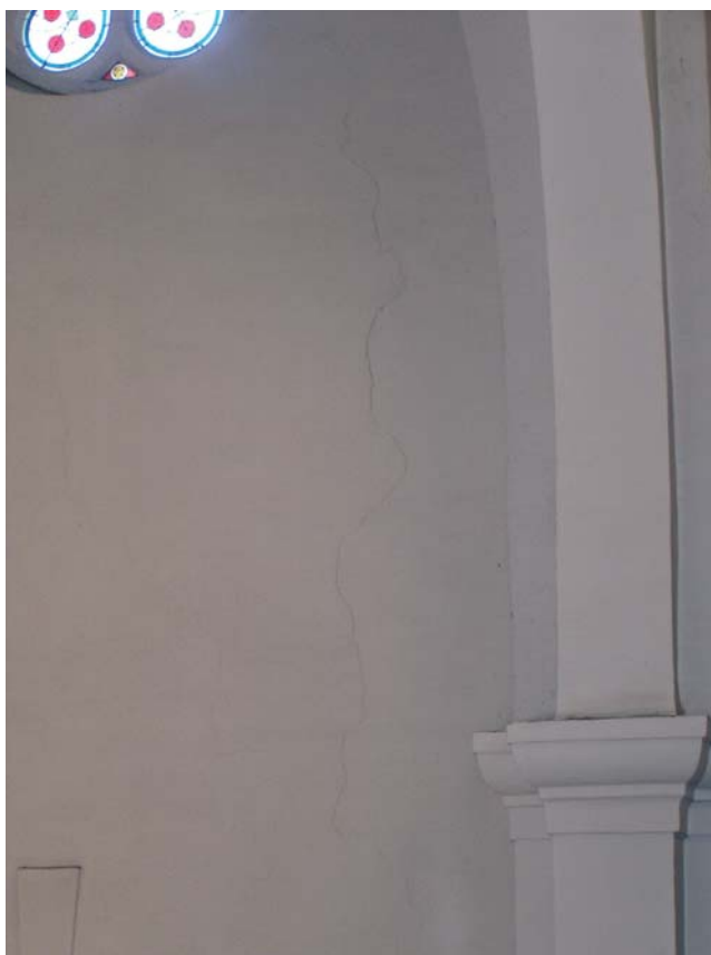
Slika 21: Napukline na zidovima
