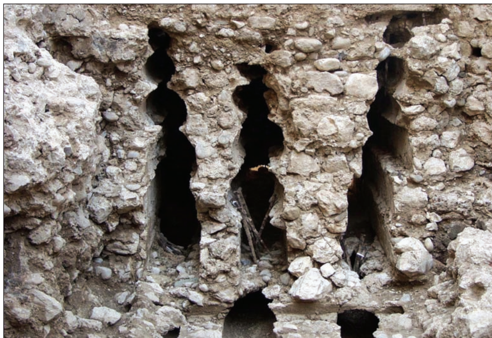
Sl. 6. Masivni željezni klinovi drvenoga kasnosrednjovjekovnoga mosta, preostali u šuplinama zidova
