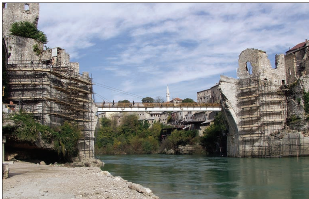
Sl. 1. Srušeni most i utvrde na Neretvi u Mostaru
