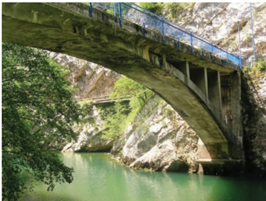
Slika 11.2: Stanje mosta prije sanacije
