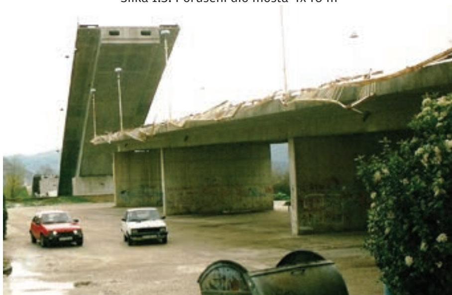
Slika 1.4: Pogled na porušeni most na desnoj obali
