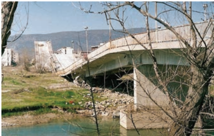
Slika 1.3: Porušeni dio mosta 4x40 m
