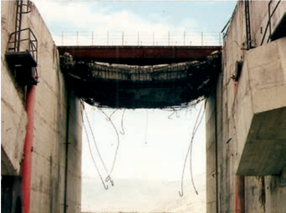
Slika 10.4: Oštećeni prijelaz i čelični most
