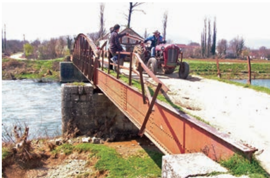
Slika 12.3: Pogled na cestovni prilaz mostu prije rekonstrukcije
